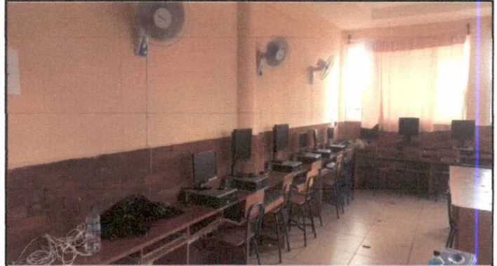
Foto 2: 17.11 Sustitución y reparación de cableado eléctrico para ventiladores en área de computación.
