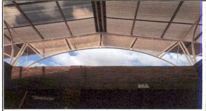
Foto 8: 2.3 Ampliación de estructura de soporte de metal en area del techo para poder evitar filtracion de agua en ingreso principal del Instituto.
