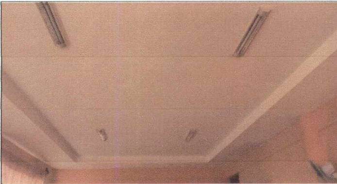
Foto 3: 17.3 Sustitución de lamparas tipo led en área de salon de computacion (Incluye sustitución de cableado y ducto eléctrico con sus respectivos accesorios)
