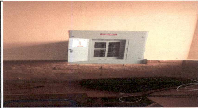
Foto 7: 19.13 Instalacion de tablero de 4 polos y 125 amperios, en area de computacion para poder alimentar las computadoras y ventiladores, con cable #6 de una caja a otra
