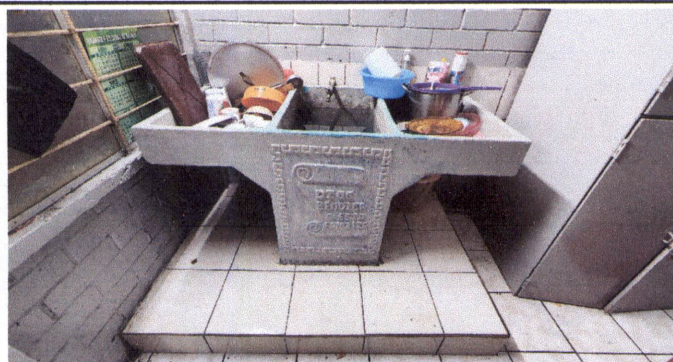
Foto 15: Sustitución de lavabastos (estado actual corroído) (incluye mezcladora) (PILA) (accesorio)
