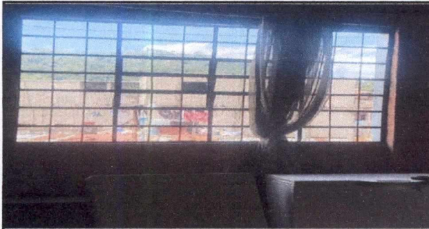
Foto 9: 5.2 SUSTITUCIÓN DE VENTANA POR VENTANA DE PVC CORREDIZA (MEDIDAS: 1.91 MTS. X 1.45 MTS.) EN DIRECCIÓN
