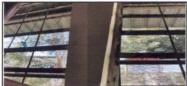
Foto 5: 5.1 MEJORAMIENTO A ESTRUCTURA DE METAL DE VENTANA (POR SEGURIDAD), INCLUYE INSTALACIÓN DE ESTRUCTURAS METALICAS ELABORADAS CON: (MALLA CALIBRE 13 CON TUBO TUBO DE 1 PULGADA CHAPA 16, PENSADO CON PLANO 3/16 POR 1/2 CON MEDIDAS DE 2.30 M. DE ANCHO POR 1.75 M. DE ALTO.
