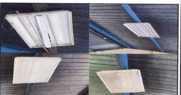
Foto 18: 17.3 SUSTITUCIÓN DE LÁMPARAS POR LÁMPARAS TIPO LED CONTRA POLVO Y HUMEDAD 2X18W (TUBO LED NEVADO) INCLUYE SUSTITUCIÓN DE CABLEADO Y DUCTO ELÉCTRICO CON ACCESORIOS, E INSTALACIÓN DE SUS RESPECTIVOS INTERRUPTORES (EN AULAS)
