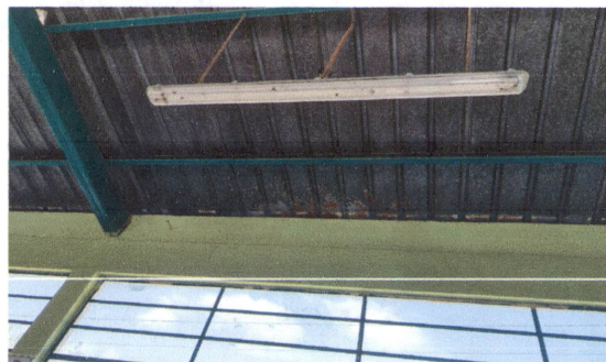
Foto 2: lámina oxidada por el agua que se cuela
