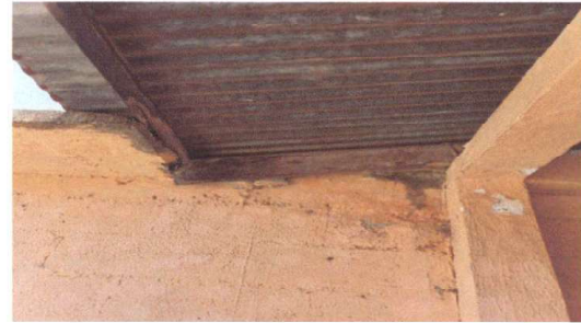
Foto 2: Complementación de canales de metal.
