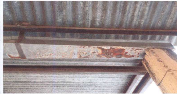
Foto 1: Los canales se encuentran en muy mal estado y ya no cumplen con su función.
