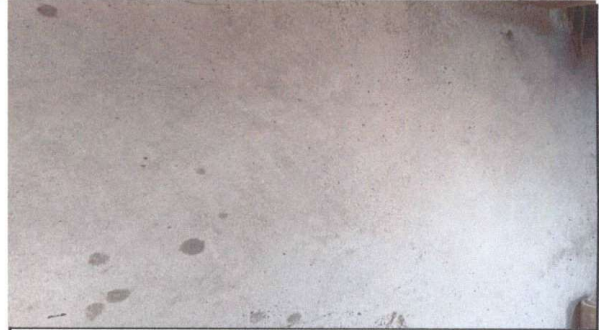
Foto 2: Sustrucción de piso de torta de concreto
