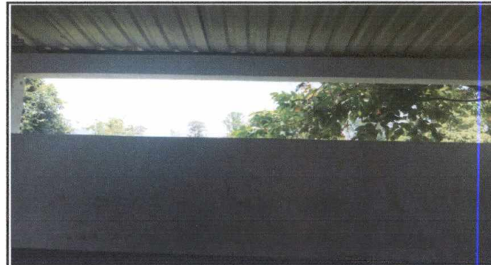
Foto 10: Instalación de puerta de metal en salón de clases que no cuenta con la misma para seguridad del salón y poderlo utilizar y ampliar nuestra cobertura
