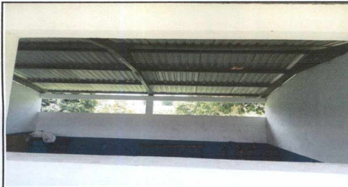
Foto 9: Instalación de puerta de metal en salón de clases que no cuenta con la misma para seguridad del salón y poderlo utilizar y ampliar nuestra cobertura
