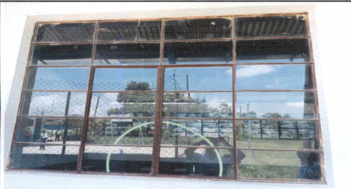
Foto 3: Sustitución de Ventana hierro por una ventana de Pvc corrediza, se realiza la sustitución por falta de ventilación de las ya existentes.
