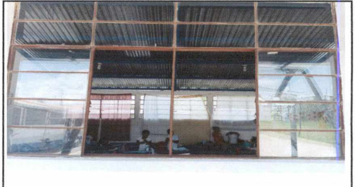
Foto 4: Sustitución de Ventana hierro por una ventana de Pvc corrediza, se realiza la sustitución por falta de ventilación de las ya existentes.
