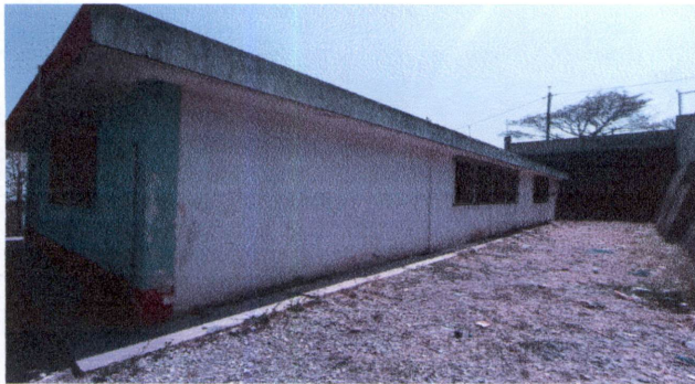
Foto 8: Repello de muros y alisado de paredes de la parte lateral del centro educativo, entrada principal
