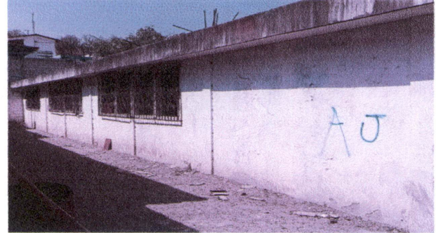
Foto 8: Repello de muros ,y alisado de paredes parte de atrás del centro educativo
