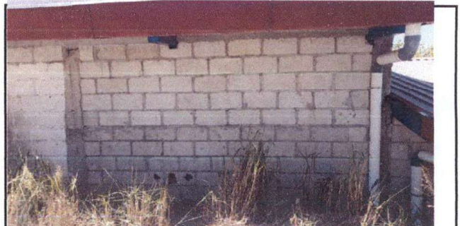
Foto 6: Parte dañada de pared de aula donde se realizara repello, sabetado y alisado para evitar filtración de agua
