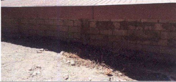
Foto 1: Se debe realizar repello, sabetado y alizado para evitar filtración de agua
