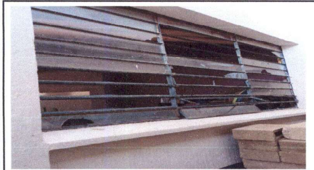
Foto 3: se trabaja sustitucion de vidrios y mantenimiento de estructura de metal de ventana
