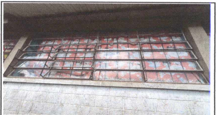
Foto 4: se cambiara todo el ventanal de la clase de segundo primaria , de atrás.
