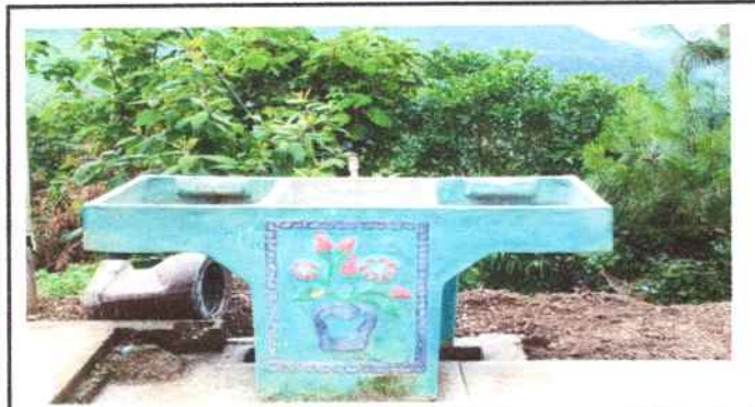
9. Instalación de pila enfrente de la cocina
