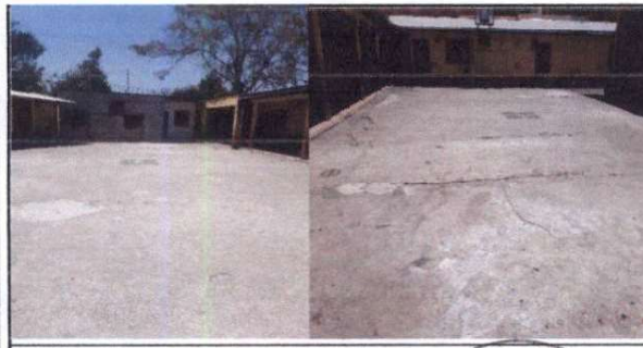
Foto 5: La losa se encuentra en mal estado
