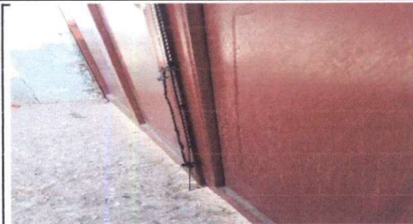
Foto 1: Mantenimiento al porton de pintura y reparación de unas partes del mismo
