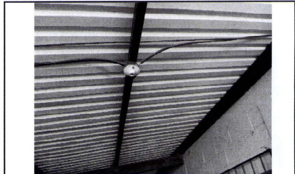
Foto 4: Sustrucción focos ahorradores y red de sistema eléctrico en plafoneras y tomacorrientes.
