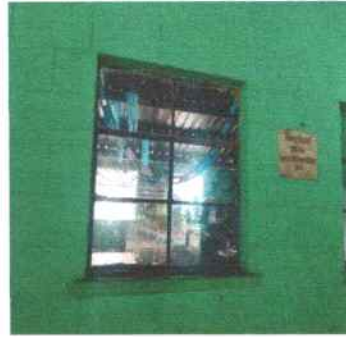
Foto 8: Aula de párvulos donde se sustituyó vidrios al frente.
