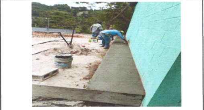
Foto 38: construcción de banca para reforzar la pared del aula de primero primaria y para que se sienten los alumnos.
