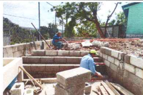
Foto 30: Construcción de gradas para llegar al nivel de la losa de patio.
