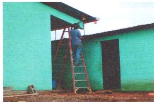
Foto 32: Instalación de pescantes para luego colocar los canales metálicos y bajadas de pvc.
