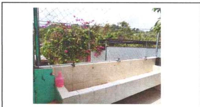
Foto 18: REPARACIÓN DE RED DE DRENAJE Y RED DE AGUA POTABLE. Se realizó la Sustitución de tubería PVC línea principal aguas pluviales por tubo galvanizado en área de lavamanos puesto que los alumnos quiebran los tubos de pvc. Sustitución de chorros.
