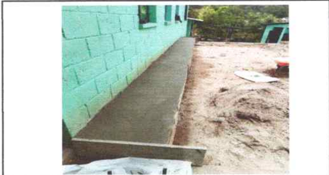
Foto 39: construcción de banca para reforzar la pared del aula de párvulos y para que se sienten los alumnos.
