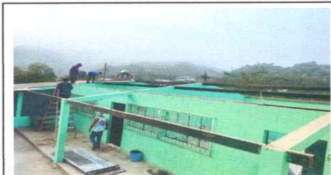
Foto 1: Desinstalación de lámina de en las aulas de Segundo y tercero primaria donde se realizará la sustitución de lámina por lámina troquelada aluzin calibre 26 y mantenimiento de techo.
