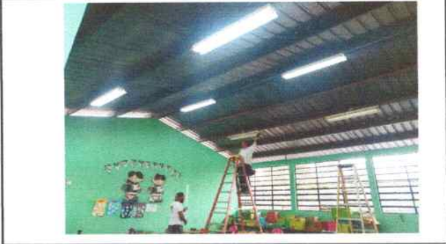
Foto 56: Reparación e instalació de lámparas de dos tubos cada una en aula de primero primaria.
