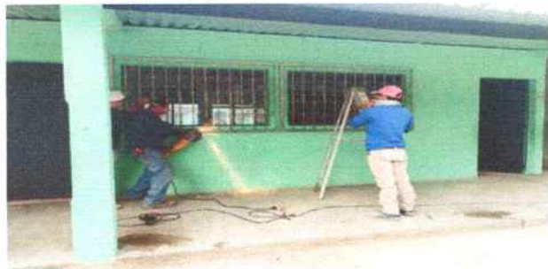
Foto 7: Aulas de segundo y tercero primaria parte de enfrente, quitaron los balcones para hacerles un mejor mantenimiento (pintar).
