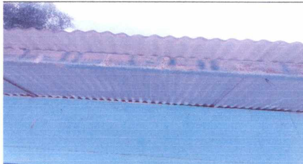
Foto 2: Mantenimiento a estructura de soporte de metal. La estructura de metal de 3 aulas necesitan el mantenimiento necesario, ya que les falta color y están oxidadas.
