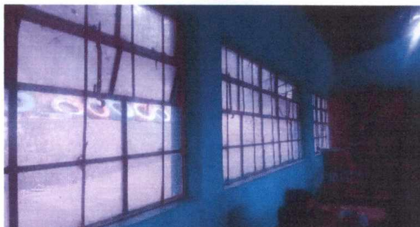
Foto 4: Sustitución de ventanas de metal por PVC corredizas. Las ventanas están deterioradas y nose tiene mucha ventilación.
