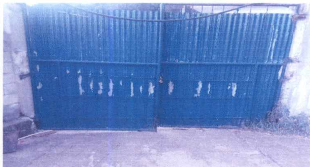
Foto 3: Fabricación e instalación de portón de metal de ingreso. El portón está deteriorado, ya que solo tiene base de metal y la lámina que lo cubre está deteriorada.
