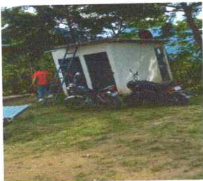
Foto1: sustitución de lámina por lámina troquelada aluzinc calibre 26 en techo del baño.
