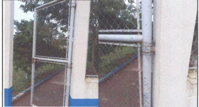
Foto 2: Se muestra la imagen correspondiente al portón de ingreso peatonal del establecimiento educativo, el mismo muestra las bases bastante dañadas.
