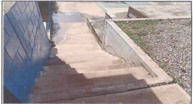
Foto 4: Se muestra el lugar, donde se realizará la intalación de una baranda tipo pasamanos en columna y gradas.
