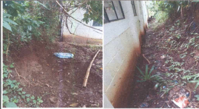
Foto 1: Se muestra las imágenes del espacio donde se contempla realizar una cuneta con rejilla, evitando la filtración de agua en las paredes de módulo 1
