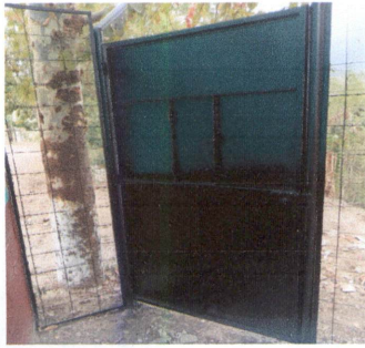
Foto 1: Instalación de la puerta que se encuentra en la parte de atrás de la escuela.
