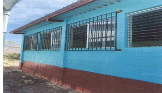
Foto 8: Pintura de las paredes de afuera que dan al patio.
