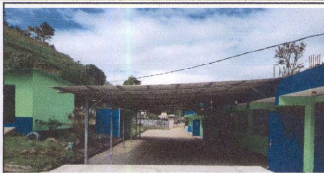
Foto 1: Ampliación de fabricación de techo principal en el patio de la escuela. Medidas 7.70*20mts.
