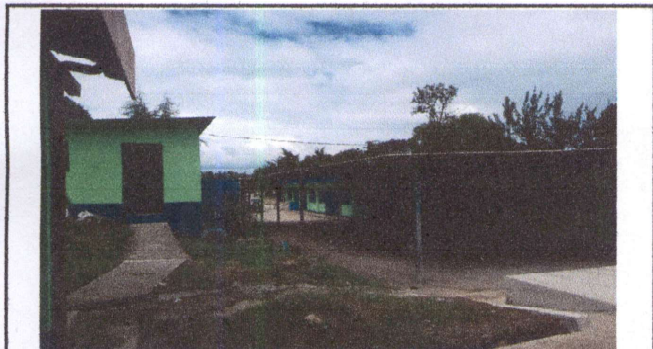
Foto 3: Ampliación de fabricación de techo de 7*2 metros, ubicados del módulo de sanitarios a la dirección de la escuela
