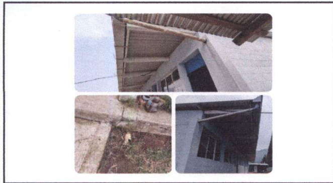
Foto 3: Módulo 2. Se evidencia el mal estado de las bajadas de agua las cuales necesitan ser reemplazadas y redireccionadas
