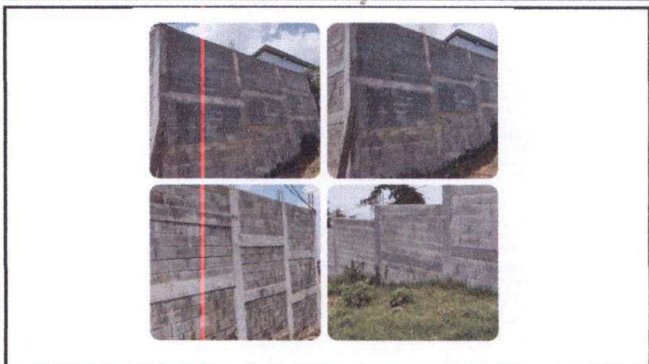
Foto 2: Módulo 1 Obra exterior. Se observa la parte de atrás de los muros y su estructura con solera cada 5 hiladas de block a excepción de 2 que necesitan ser reforzadas
