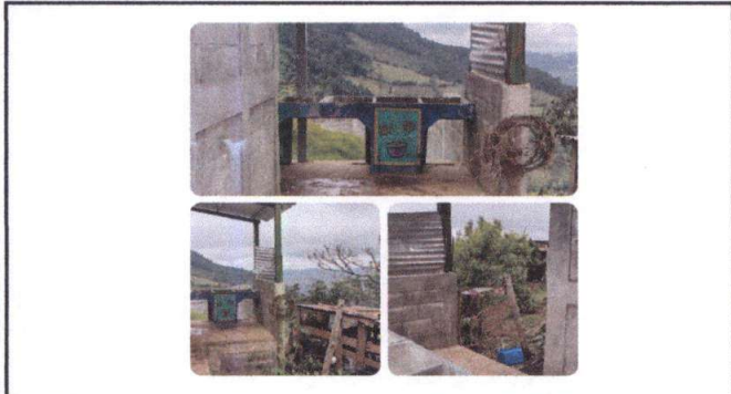
Foto 9: Módulo 3. En la imagen se puede observar la parte de atrás de los sanitarios que es un lugar vulnerable en donde se necesita una reja que brinde mayor seguridad a los estudiantes y al edificio.
