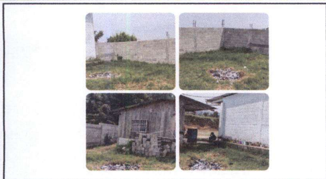
Foto 1: Módulo 1 obra exterior. Se puede observar el área destinada para bodega y los muros a los cuales les hace falta altura.
