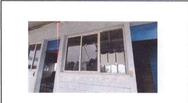
Foto 8: Módulo 1. En la imagen se puede observar el ventanal del frente de la dirección al cual le hace falta un balcón que brinde mayor seguridad, la parte de atrás ya cuenta con balcón. Foto
