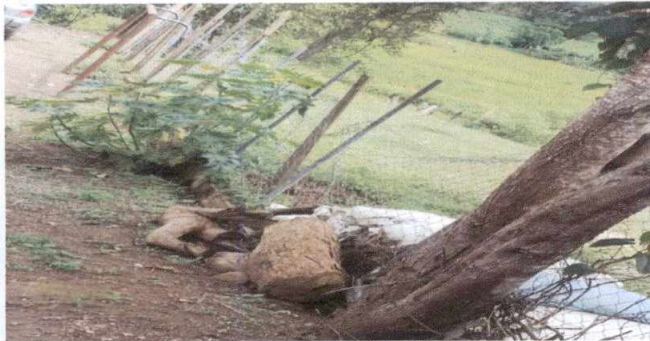
Foto 1: CONDICIONES DEL MURO PERIMETRAL LADO LATERAL DERECHO.
