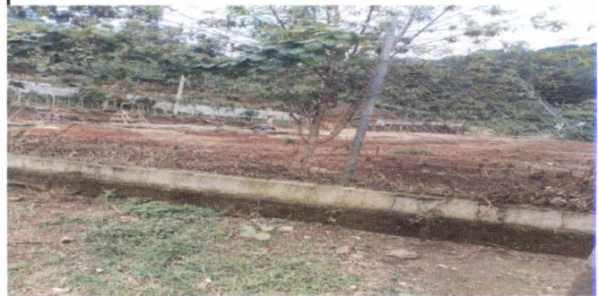
Foto 4: EL DETERIORO DEL MURO AFECTA QUE PERSONAS AJENAS A LA COMUNIDA EDUCATVA INGRESEN DE MANERA INRESPECTUOSA A LAS INSTALACIONES.
