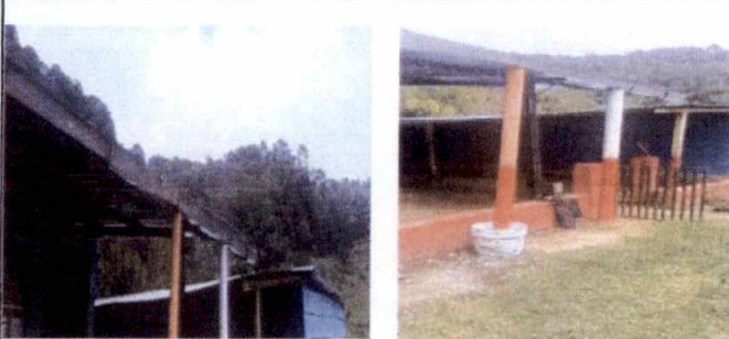
Foto 3: sustitución de canal de metal enfrente de la escuela.
