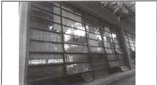
Foto 7: Se harán 11 sustituciones de vidrio (Renglón 5.5) y sustitución de ventanas de metal (renglón 19.17).
