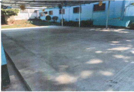
FOTO 3: TORTA DE CONCRETO EN PATIO
