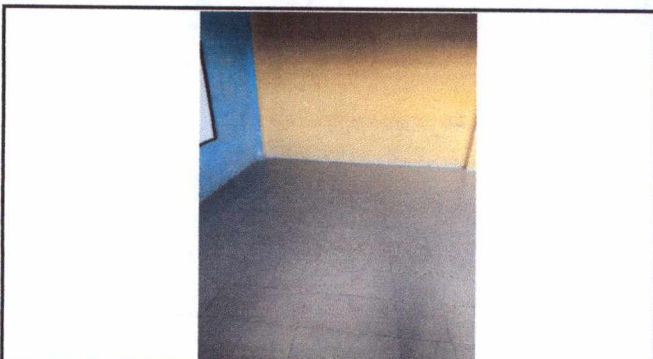
Foto 4: Vista del interior del aula de quinto con pisos dañados.
