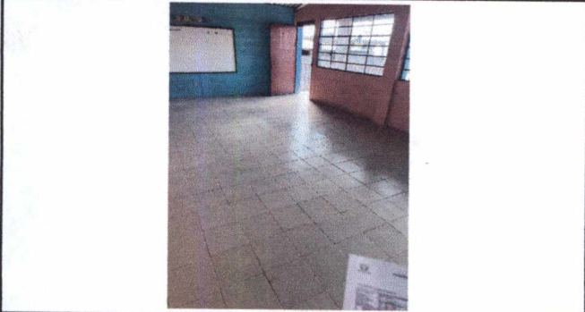
Foto1: Vista del interior de una aula vacia dañados y quebrados.
