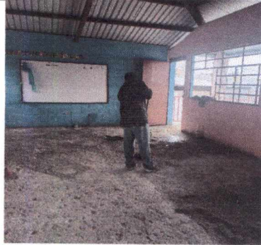
Foto1: Vista del interior de una aula vacia dañados y quebrados.
