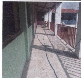
Foto 6: Vista del corredor principal segundo nivel con pisos dañados.
