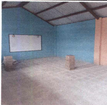
Foto 3: Vista del interior de aula de sexto grado con pisos dañados.
