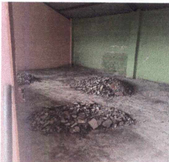
Foto 5: Vista del interior de aula vacia segundo nivel con pisos dañados.
