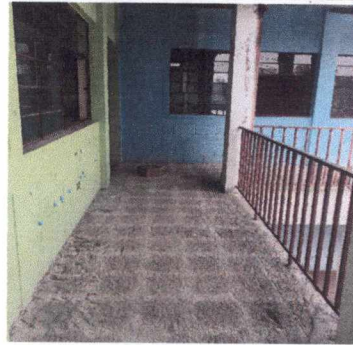
Vista del corredor según nivel frente a la biblioteca con pisos dañados.
