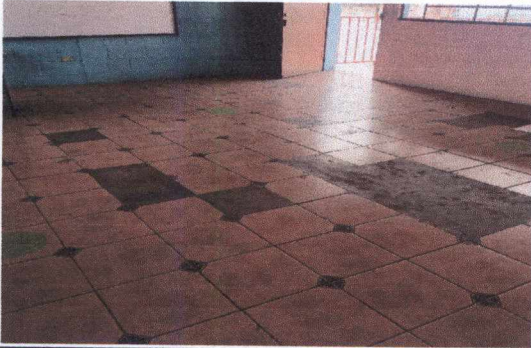
Foto 1: Vista del interior de una aula vacía dañados y quebrados.
