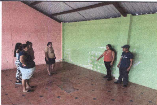
Foto 5: Vista del interior de aula vacía segundo nivel con pisos dañados.
