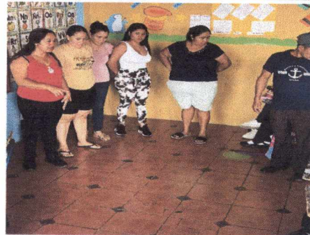
Foto 4: Vista del interior del aula de quinto con pisos dañados.
