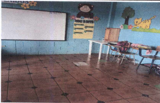
Foto 3: Vista del interior de aula de sexto grado con pisos dañados.
