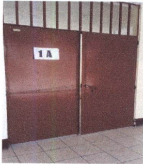
Foto 1: Sustrucción de chapa.
