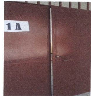
Foto 2: Sustrucción de chapa.
