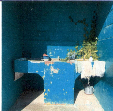
Foto 2: Sustrucción de pila en mal estado.
