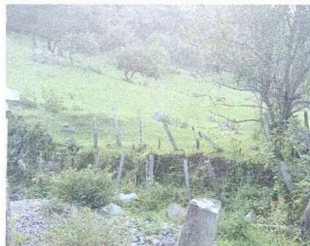
Foto 4: Falta de cerco o muro perimetral
