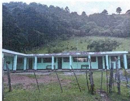
Foto 3: Falta de cerco o muro perimetral
