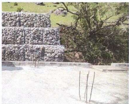
Foto 5: Falta del impermeabilización de losa
