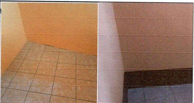
Foto 5: REPARACIÓN O SUSTITUCIÓN DE ÁREA DE COCINA ( Construcción de gabinete de concreto, que en total suman 14.00 m2, colocación de 5 puertas de metal)
