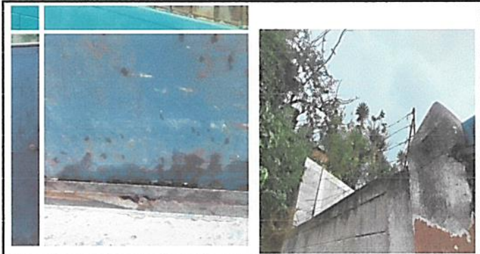
Foto 8: PINTURA DE MUROS EXTERIORES E INTERIORES (APLICACIÓN DE PINTURA DE 124 M2 EN MUROS EXTERIORES)
