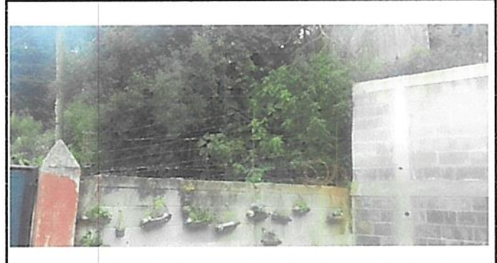
Foto 9: CERCO O MURO PERIMETRAL (SUMINISTRO DE MURO PERIMETRAL DE 1.80X4.30 METROS PARA COMPLETAR MURO YA EXISTENTE)
