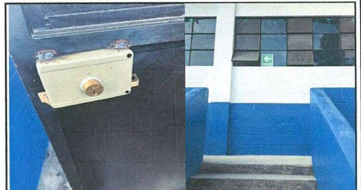
Trabajos adicionales: reparación de ventanas y chapas a puertas en edificio de primaria.
