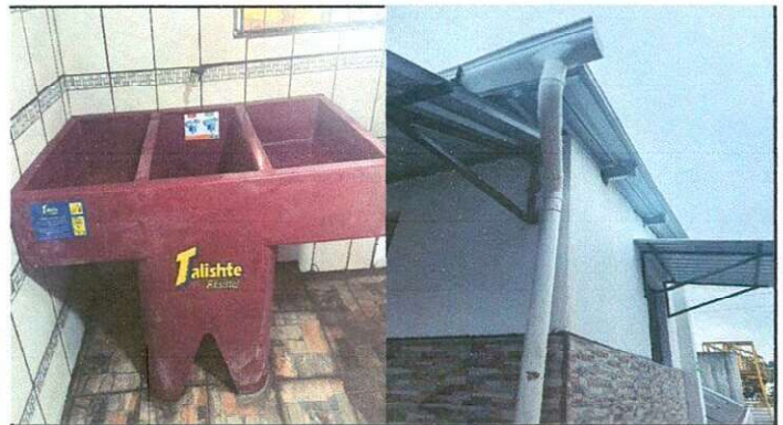
Reparación de red de agua potable, sustitución de tubería PVC, sustitución de tubería PVC de aguas pluviales, sustitución de llave de chorro.
