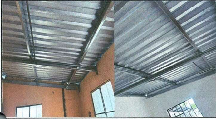
Sustitución de cubierta de lámina por lamina nueva troquelada calibre 26 en area de cocina.
