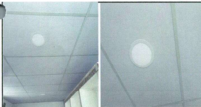
Reparación de sistema eléctrico, sustitución de focos ahorradores, sustitución de interruptores dobles, sustitución de cableado eléctrico, sustitución de duaeléctrico con accesorios.
