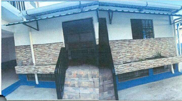
Sustitución de canal de PVC , sustitución de bajada de agua pluvial por tubo PVC y sustitución de soporte de metal para canal.
