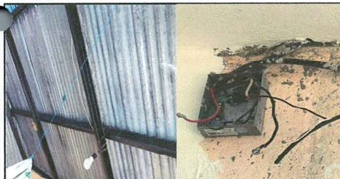
Reparación de sistema eléctrico, sustitución de focos ahorradores, sustitución de interruptores dobles, sustitución de cableado eléctrico, sustitución de duoelectrico con accesorios.
