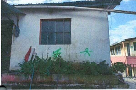
Sustitución de canal de PVC , sustitución de bajada de agua pluvial por tubo PVC y sustitución de soporte de metal para canal.
