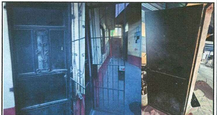
Mantenimiento de estructura, lijado y aplicación de pintura a puerta y reja, sustitución de puerta metálica.
