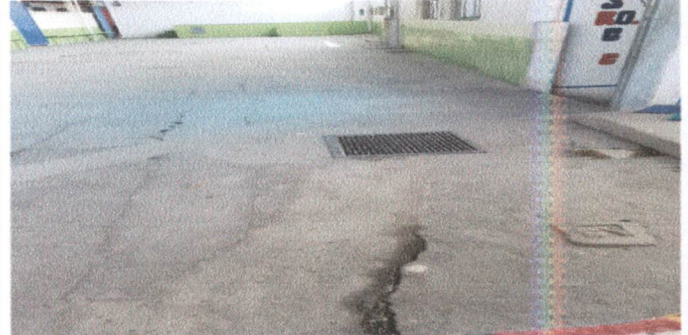
Foto 8: PISO-corredor principal, deterioro general, grietas, hundimientos, partes sin torta y agujeros en diferentes parte.
