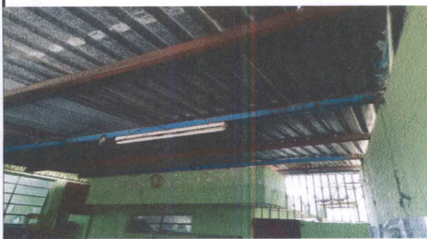
Foto 3: ESTRUCTURA DE TECHO - cocina y corredor de preprimaria, la estructura se encuentra oxidada y picada.
