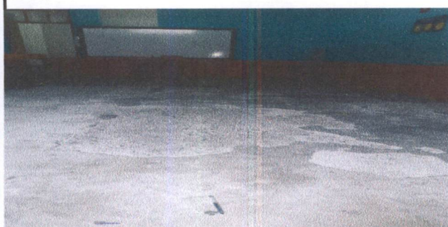
Foto 5: PISO - salón de segundo A, el piso de concreto está totalmente deteriorado.
