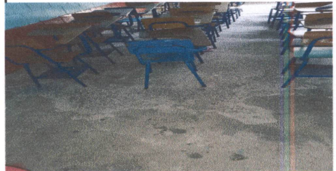
Foto 6: PISO - salón de segundo A, deterioro de toda la capa superior de la torata de concreto.
