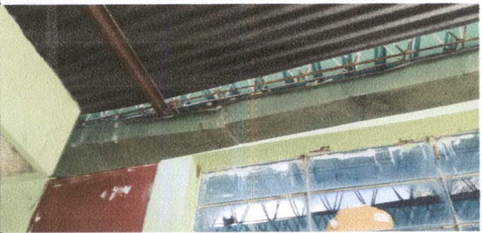
Foto 9: CANALES Y BAJADAS DE AGUA PLUVIAL- cocina y corredor de preparatoria, canales en mal estado.
