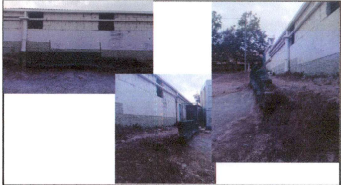
Foto 4: Sustitución de muro perimetral de block con tubo hg y malla galvanizada, soleras intermedias y columnas.
