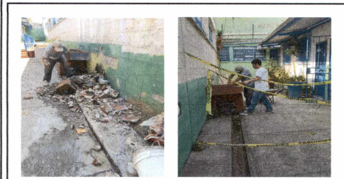
Foto 9: Sustitución de dos pilas de dos lavaderos. Incluye: desmontar, instalar pilas, instalar drenaje y sustitución de chorros.
