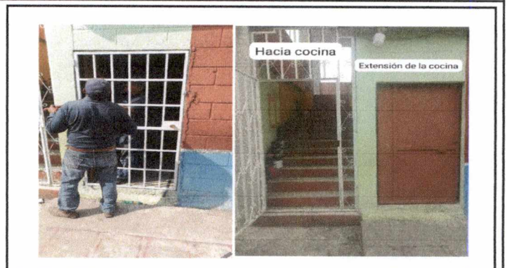
Foto 8 : Fabricación e instalación de puerta de reja en el área de cocina (Primer nivel)
