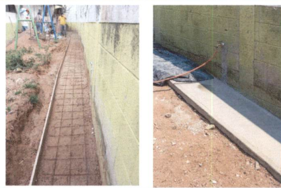
Foto 14: REPARACIÓN DE BANQUETAS DE CONCRETO: Fundición de banqueta, Incluye: nivelación, compactación + fundición de concreto 3,000 psi con acabado rustico. Colocación de chorro
