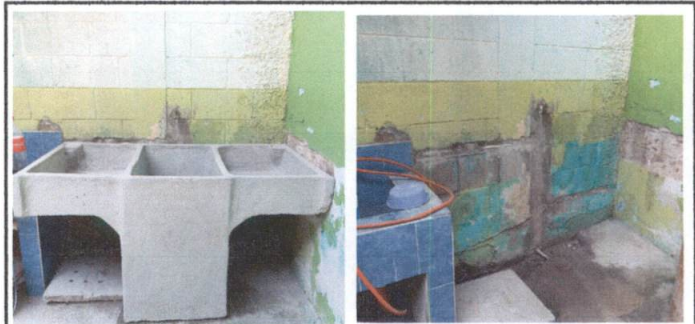
Foto 6: INSTALACIÓN DE PILA: Sustitución de pila de un lavadero, área exterior (patio)
