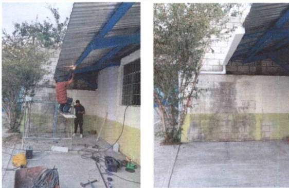
Foto 15: REPARACIÓN DE BAJADA DE AGUA PLUVIAL Reparación de caída de agua sobre muro afuera de salón. Incluye: Colocación de 1.00m. De canal de alto caudal pvc y colocación de bajada con tubo pvc de 3"
