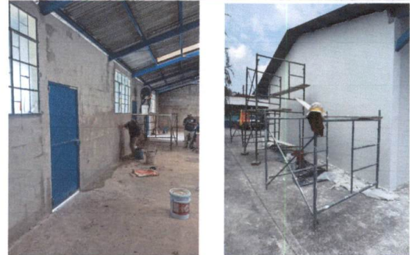
Foto 8: REPELLO Y CERNIDO Acabado, Base Gris y base blanca Monocapa, área de salón interior y exterior
