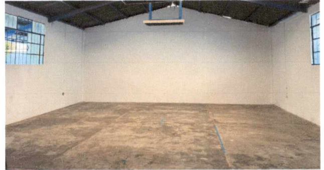
Foto 2: PISO Instalación de piso de granito .30x.30 en salón de usos múltiples
