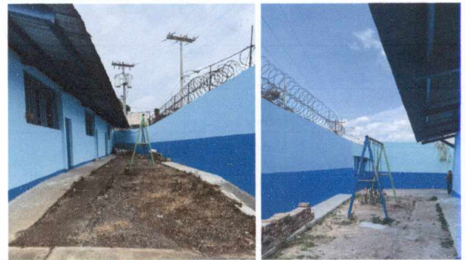
Foto 4: LOSA DE PATIO Fundición de planchas de concreto en patio de 10cms de espesor reforzada con electromalla
