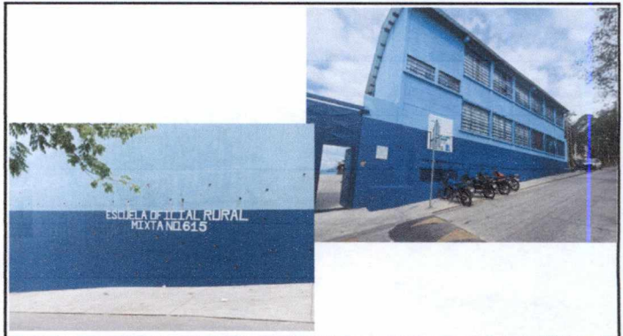
Foto 4: Frente externa de la escuela y entrada . Pintar zócalo
