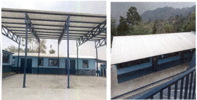
Foto 3: Trabajo de canales y bajadas de agua en techo de patio de Preprimaria y techo de módulo 2 de Primaria.
