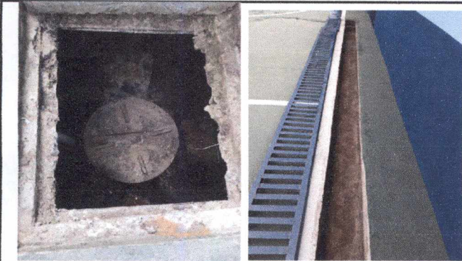
Foto 9: 14 REPARACION DE RED DE DRENAJE Y RED DE AGUA POTABLE Mantenimiento a caja de registro
