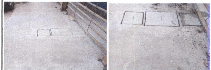
Foto 12: 14 REPARACION DE RED DE DRENAJE Y RED DE AGUA POTABLE Reparación de caja de contador.
