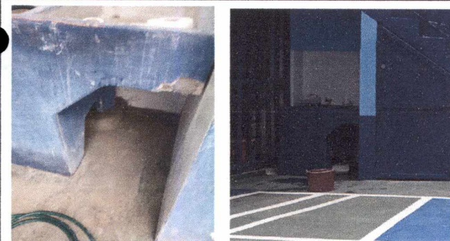
Foto 11: 14 REPARACION DE RED DE DRENAJE Y RED DE AGUA POTABLE Reparación de caja de registro
