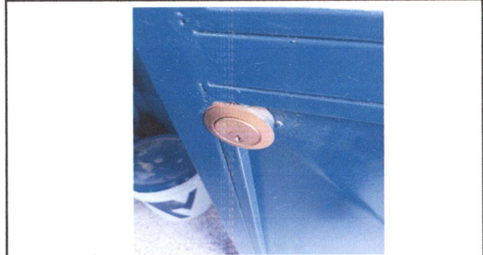
Foto 2: 4. PUERTA DE METAL Sustitución de Chapa
