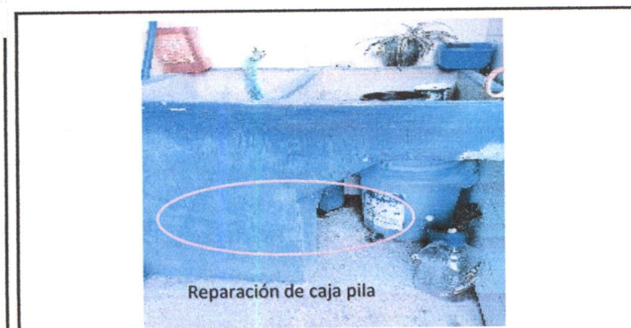
Foto 11: 14 REPARACION DE RED DE DRENAJE Y RED DE AGUA POTABLE Reparación de caja pila
