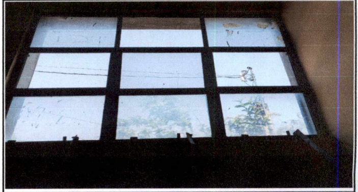
Foto1: Mantenimiento de estructura de ventana y vidrio a 12 metros cuadrados incluyendo limpieza y pintura, en salones 2 y 3 del primer nivel.
