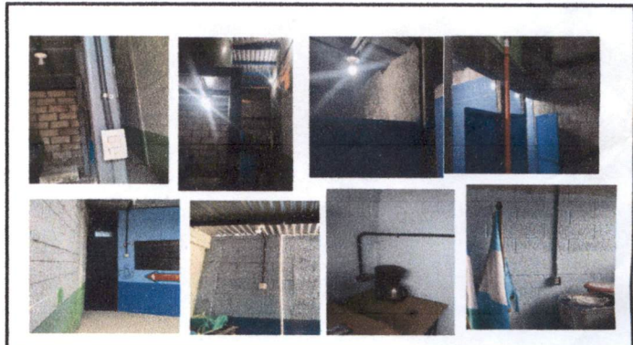
Foto 10: Cambio de Suich y tomacorrientes de luz , revisar plafoneras y cables en mal estado.
