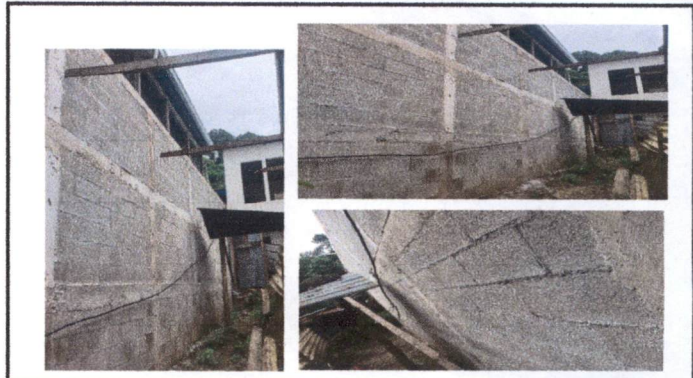
Foto 8: Pared atrás de la Escuela Presenta socavamiento en cemento y se esta rajando en varias áreas. . (colinda con barranco terreno de un vecino)
