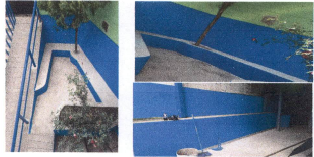
Foto 2: Reparar muro de contención con piedra, electromalla y recubrimiento de concreto, Reinstalación y reparación de banquetita para niños, Muro de el lado de enfrente se esta desboronando. Area de baños
