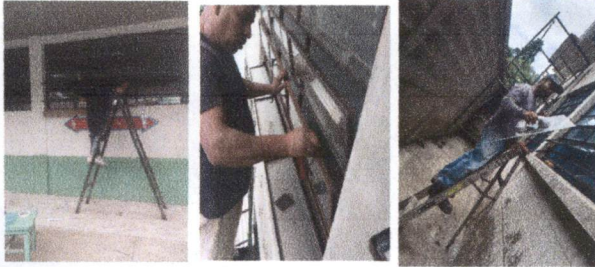
Foto1: cambiar todos los vidrios que se encuentren quebrados, echar silicon donde falte, limpiar balcones y pintarlos
