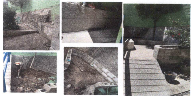
Foto 2: Reparar muro de contencion con piedra, electromalla y recubrimiento de concreto, Reinstalación y reparacion de banquetita para niños, Muro de el lado de enfrente se esta desboronando. Area de baños
