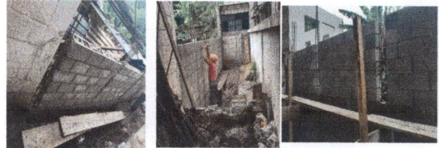
Foto 8: Pared atrás de la Escuela Presenta socavamiento en cemento y se esta rajando en varias áreas. . (colinda con barranco terreno de un vecino)
