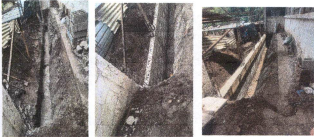
Foto 7: Pared atrás de la Escuela Presenta socavamiento en cemento y se esta rajando en varias áreas. . (colinda con barranco terreno de un vecino)
