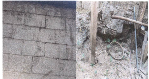
Foto 8: Pared atrás de la Escuela Presenta socavamiento en cemento y se esta rajando en varias áreas. . (colinda con barranco terreno de un vecino)
