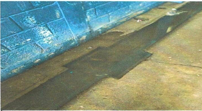
Foto 3: PARRILLA PARA CUBRIR PASO DE AGUA DRENAJE
