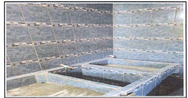
Foto: 1 arreglo de lavado
