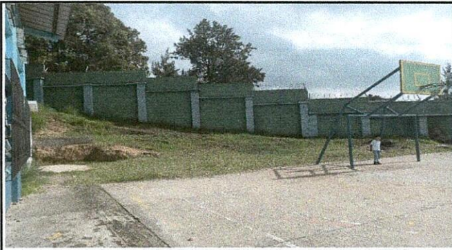
FOTO 7: LEVANTADO DE 15 METROS DE 2 HILADAS DE BLOCK Y MALLA DE 1.50 METROS DE ALTURA
